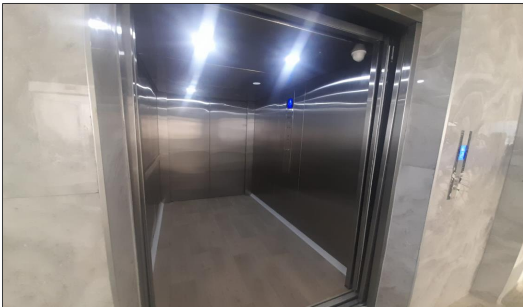
Imagen 13 Ascensor de tres paradas en funcionamiento
